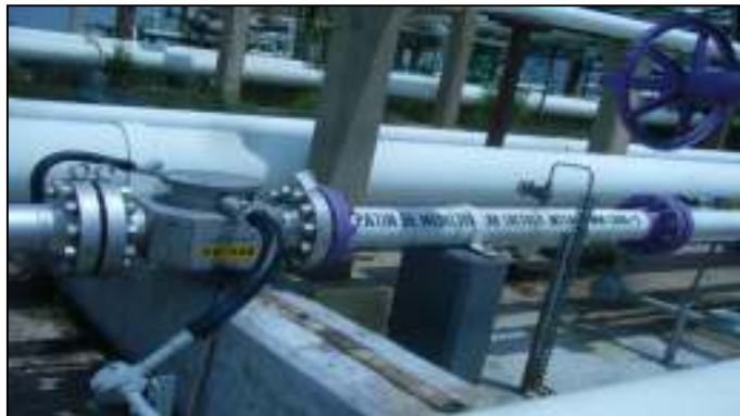
MEDIDOR ULTRASÓNICO INSTALADO EN LA SALIDA DE LA CENTRAL DE ALMACENAMIENTO Y BOMBEO CACTUS
