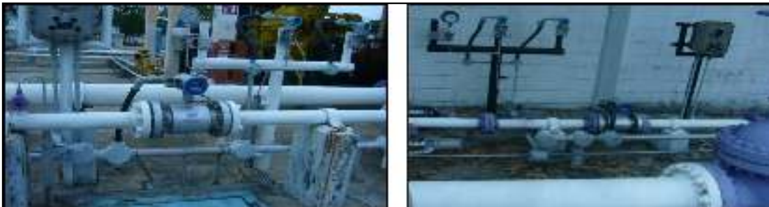
MEDIDORES ULTRASÓNICOS INSTALADOS EN LA SALIDA DE LAS BATERÍAS DE SEPARACIÓN ARTESA Y SITIO GRANDE
