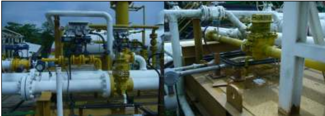
MEDIDORES DE TIPO PLACA DE ORIFICIO INSTALADOS EN LAS LINEAS DE DESCARGA DE LOS COMPRESORES DE LA ESTACIÓN DE COMPRESIÓN GIRALDAS
